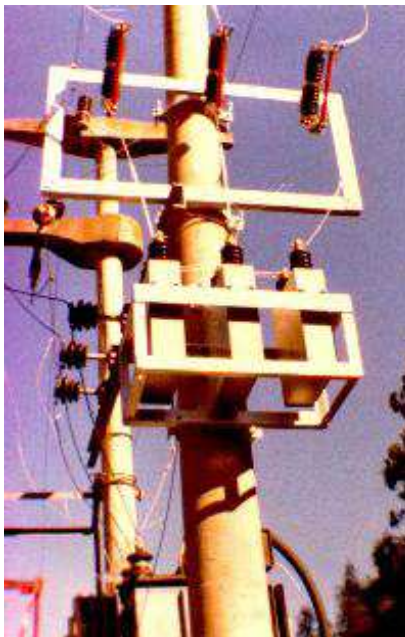
Figura 2.19 Banco de condensadores fijos en medio voltaje
