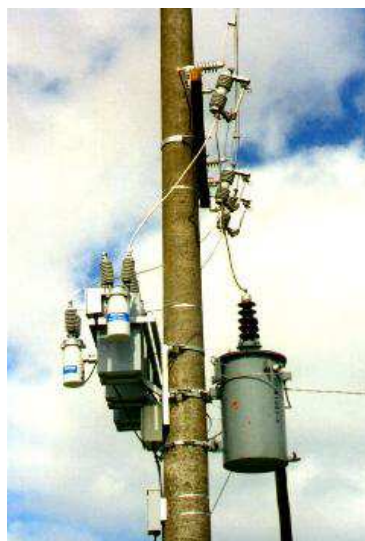
Figura 2.21 Banco de condensadores automáticos en medio voltaje
