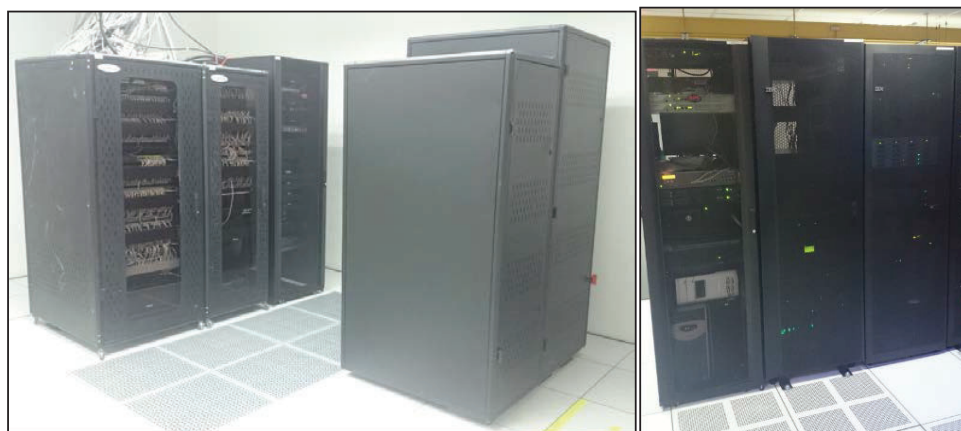
Figura 3.1.5.5 Racks de Servidores y Telecomunicaciones DC ANT – CNT.
