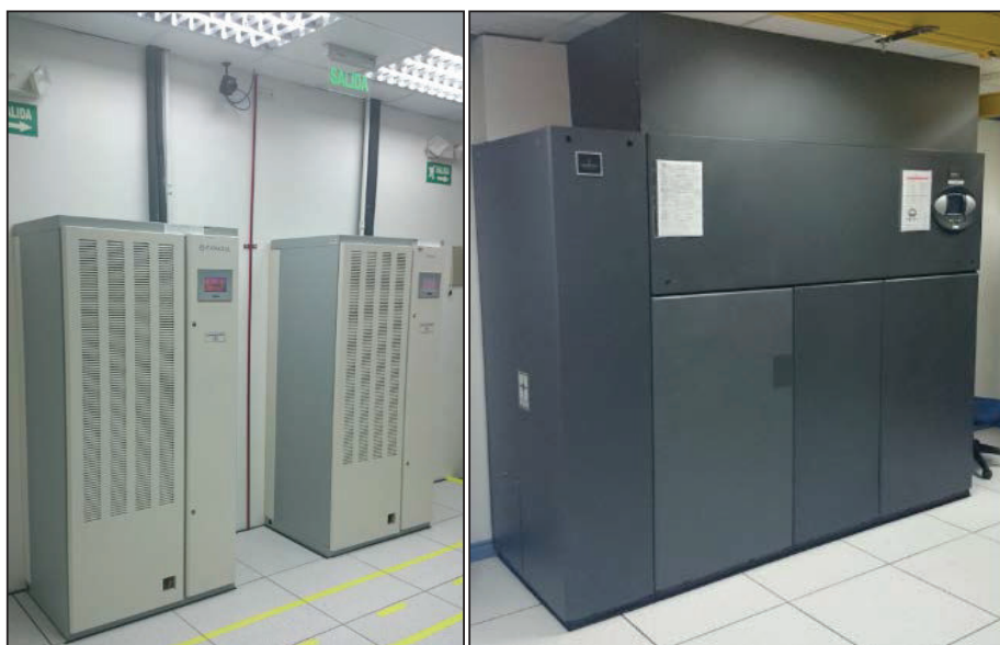
Figura 3.1.5.4 Sistema de Aire Acondicionado de Precisión DC ANT – CNT.
