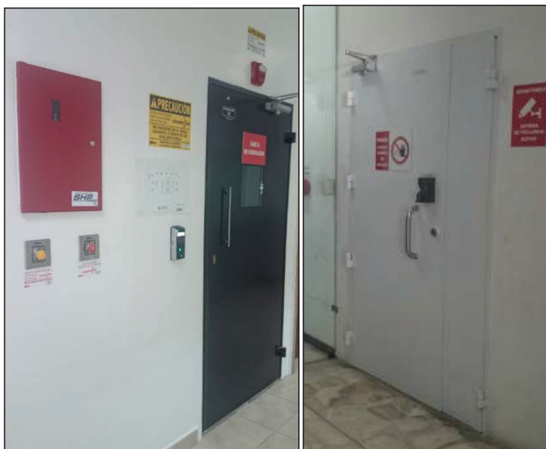
Figura 3.1.5.2 Sistema de Control de Acceso DC ANT – CNT.
