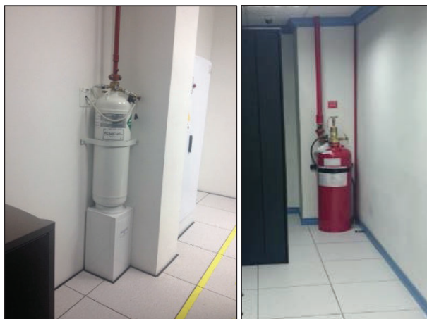
Figura 3.1.5.3 Sistema de Detección y Extinción de Incendios DC ANT – CNT.
