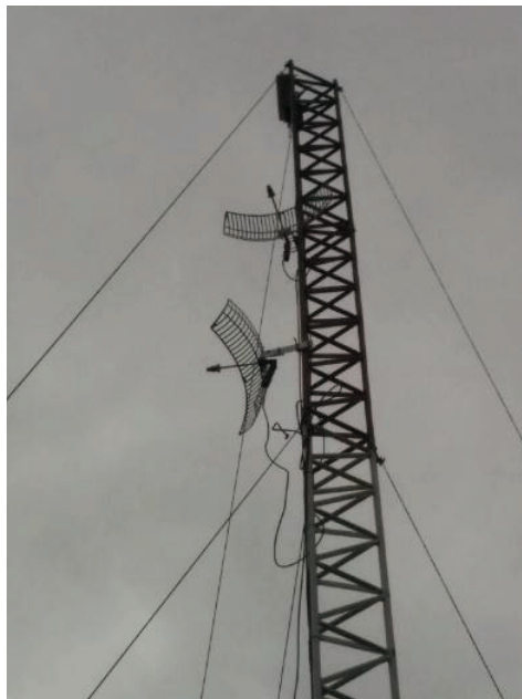
Figura 2.10 Equipos instalados en Torreta del Nodo Principal
