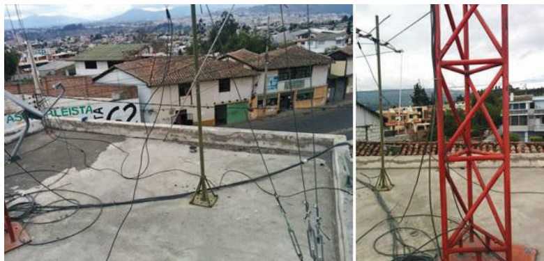
Figura 2.22 Cableado en terraza del nodo principal
