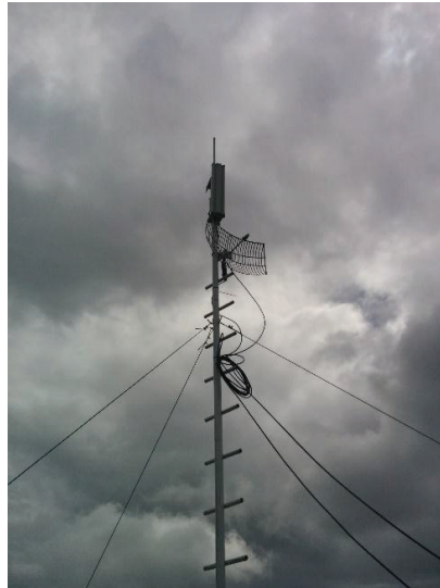
Figura 2.12 Equipos instalados en la torreta del nodo Techo Propio
