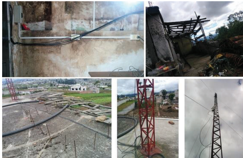
Figura 2.24 Cableado del nodo Quillán Loma
