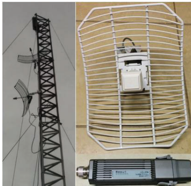
Figura 2.18 Antenas tipo grilla instaladas en torreta
