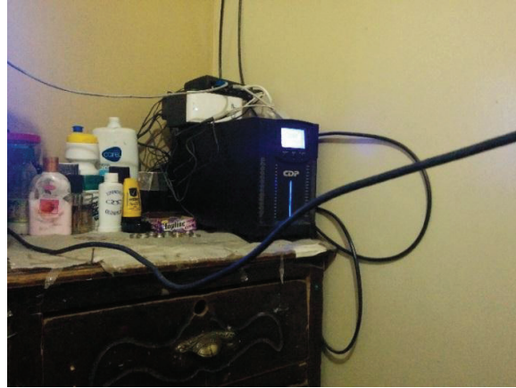
Figura 2.25 Equipos del nodo Techo Propio
