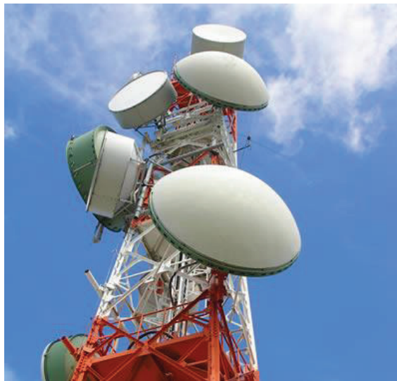
FOTOGRAFÍA 2.4. Antena parabólica con radomo
