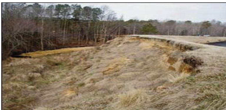
GRÁFICO 3.2.1 DESLIZAMIENTO DE UN TALUD.
