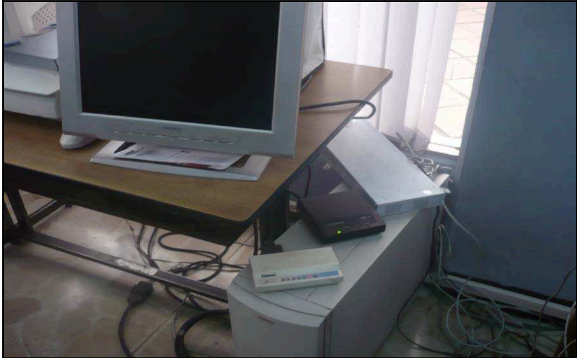
Figura 2.9. Ubicación actual de Servidor (Centro de Documentación Técnica)
