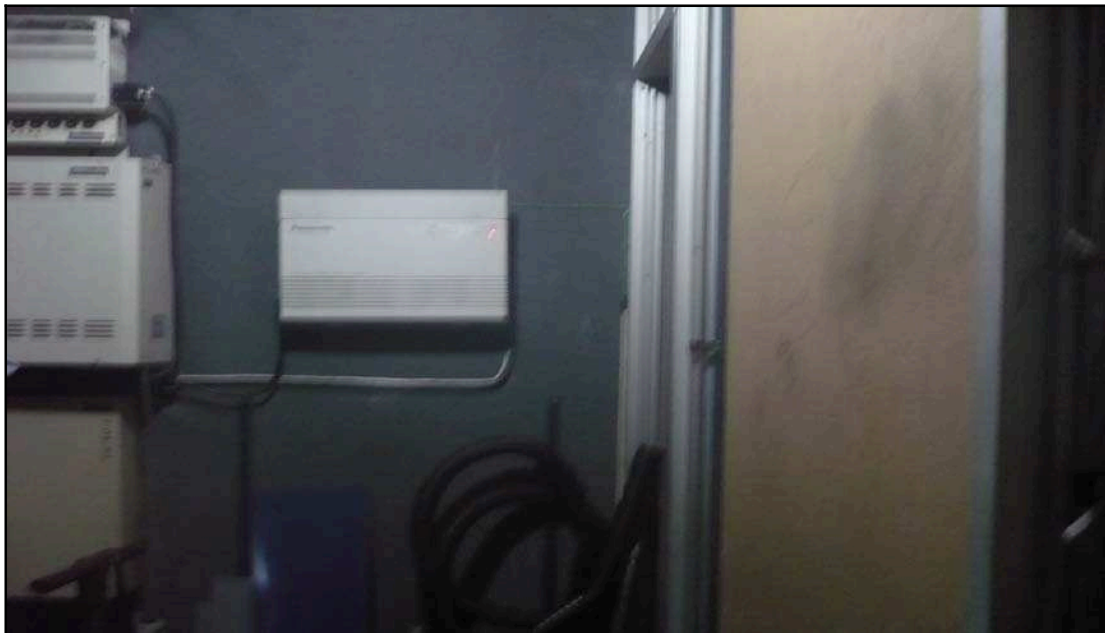
Figura 2.12. Ubicación actual de la Central Telefónica (Unidad de Capacitación)
