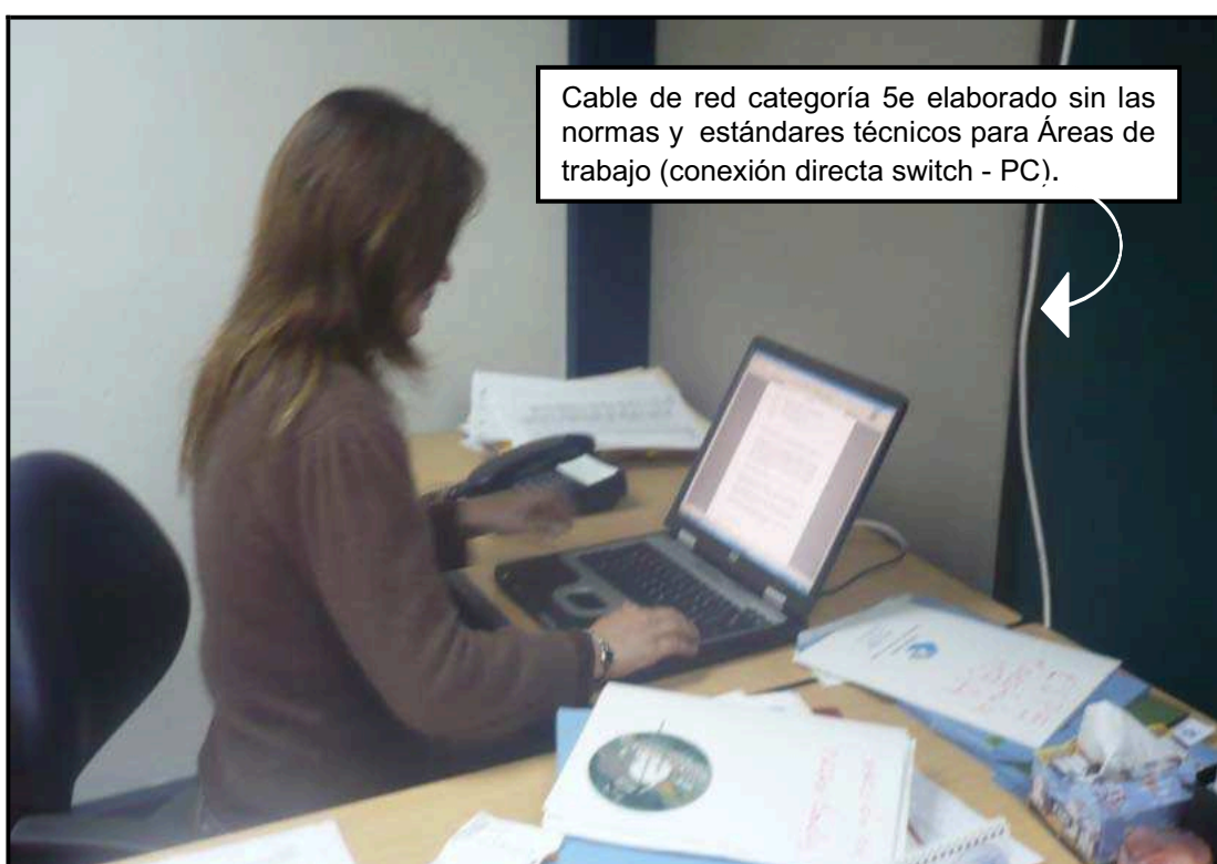
Figura 2.15. Área de Trabajo, Unidad de Capacitación (Oficina Postgrados)
