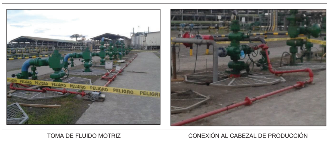
FIGURA 4.6: INSTALACIONES DE SUPERFICIE PROVISIONALES PARA PRODUCIR EL POZO EM X1
