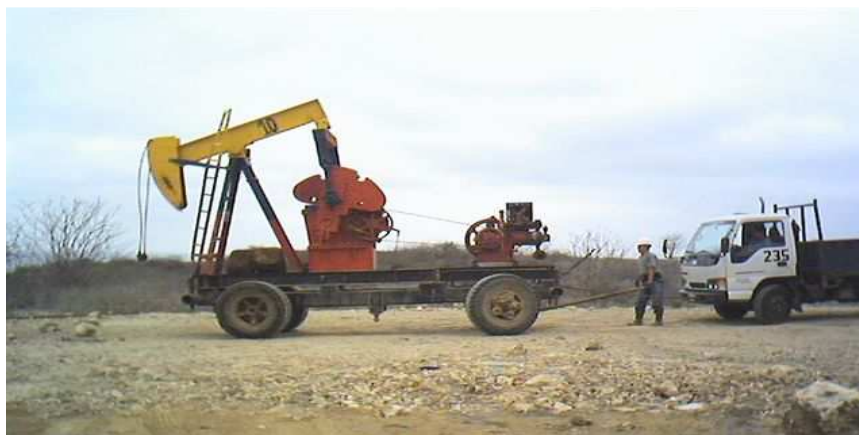
Figura 2.3 Bombeo Mecánico Portátil
