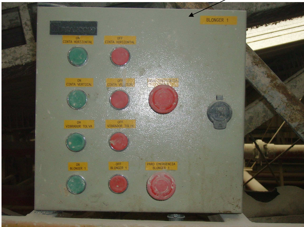
FIG 3.11 Tablero de control cintas blonger
