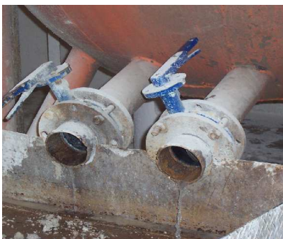
FIG # 3.1-A Válvulas de salida
