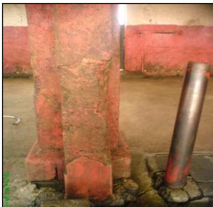
Foto 3.9. Columnas en mal estado.
