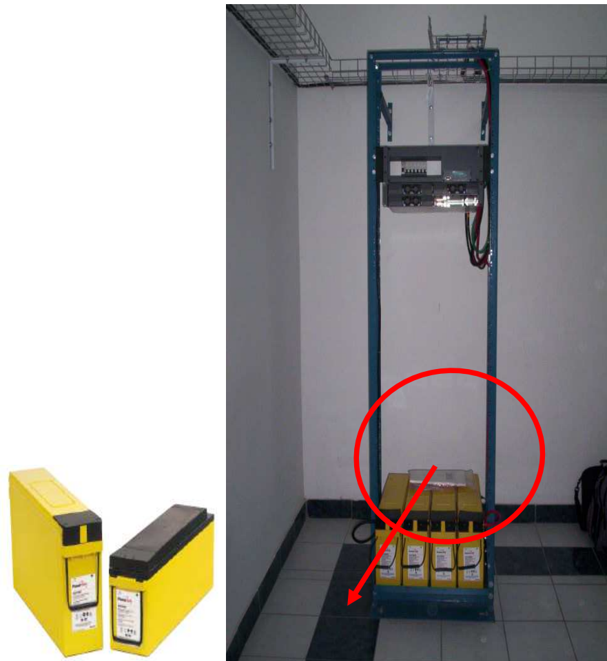
Figura: 2.10 Banco de baterías instalado en el rack de energía.
