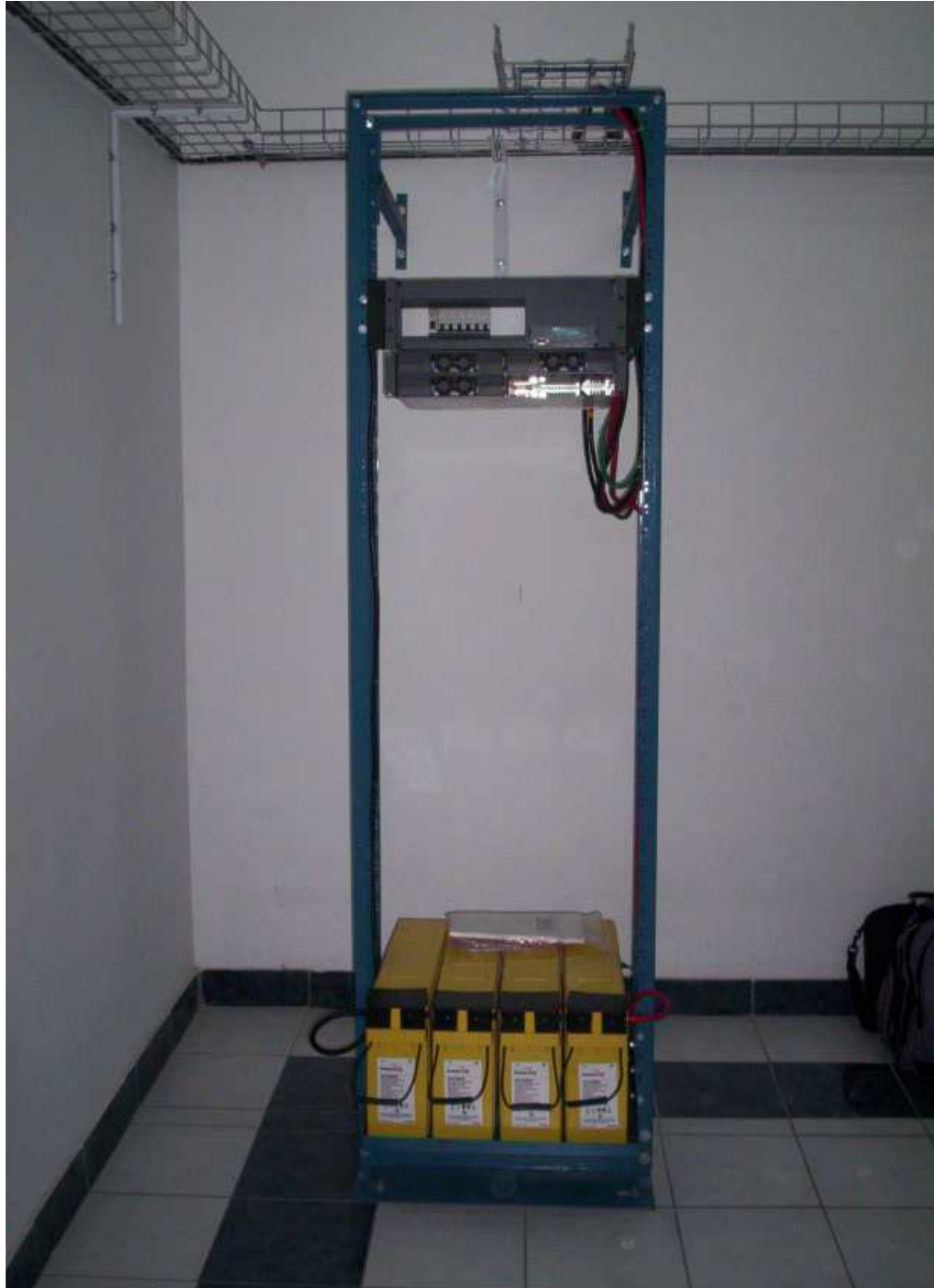
Figura: 3.4 Banco de Baterías instalada en el rack de energía.
