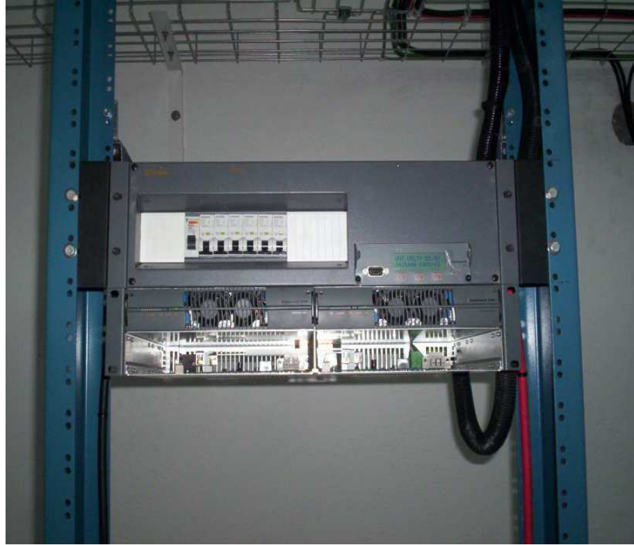
Figura: 2.3.1 Equipo rectificador instalado en el Rack.
