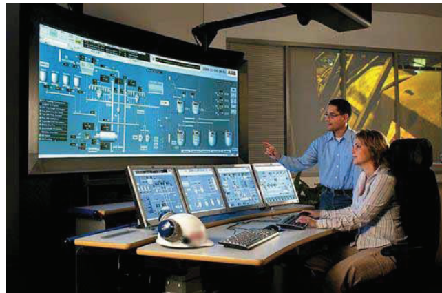
Fig. 74 Conexión remota, panel de control SCADA 52
