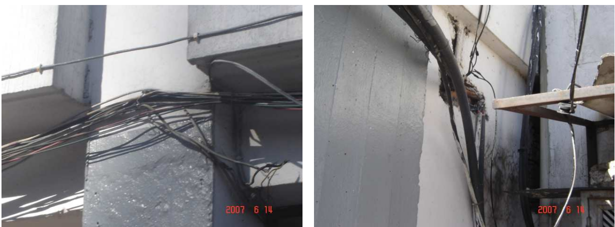
Fig. 1.2: Conductores en mal estado, con empalmes mal realizados expuestos a la intemperie.
