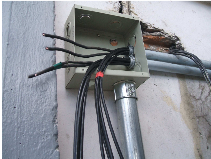
Fig. 5.2: Caja de conexión entre tablero principal y sub-tableros.
