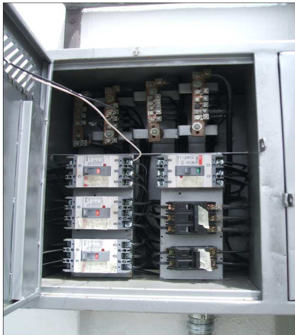
Fig3.10: Interruptores Derivados colocados en el tablero principal.
