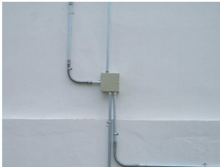
Fig. 5.10: Acometida en tubería conduit para el bloque 2.
