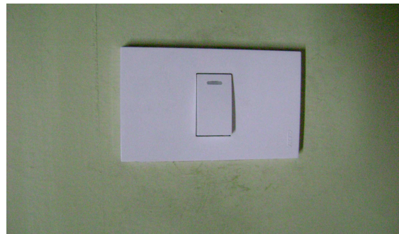
Fig. 5.5: Tipo de interruptor instalado.
