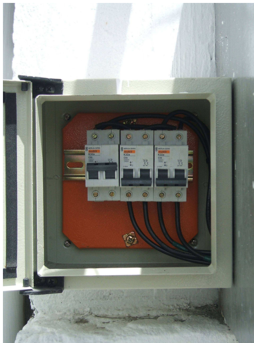
Fig. 5.9: Caja de breakers para accionamiento de reflectores.
