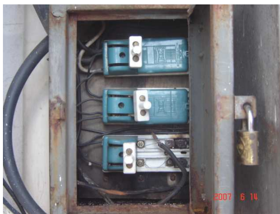
Fig. 1.7: Caja de interruptores para los reflectores, que se encontraban dañados, con conexiones sueltas y en mal estado.
