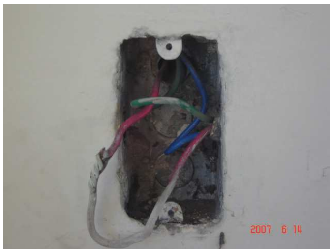
Fig. 1.5: Cajas sin interruptores que ocasionaban accidentes a las personas.
