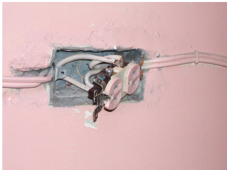
Fig. 1.10: Tomacorrientes en mal estado con sus conexiones expuestas.
