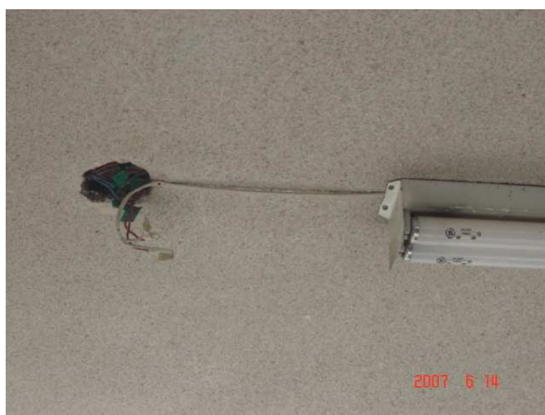
Fig. 1.6: Empalmes mal realizados.
