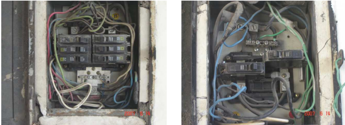
Fig. 1.3: Subtableros en mal estado, con algunos circuitos sin protección.
