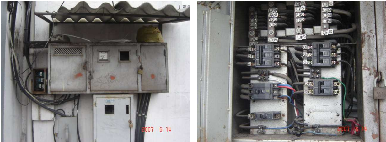
Fig. 1.1: Estado en el que se encontró el tablero principal de distribución.
