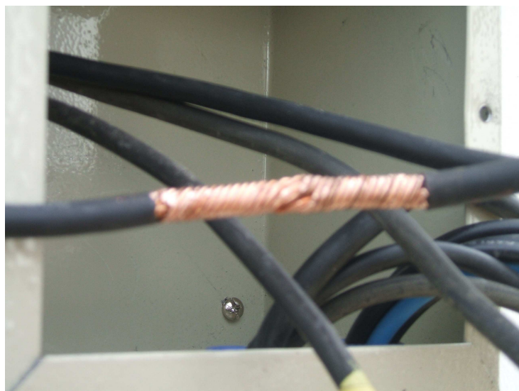
Fig. 5.11: Empalmes realizados en las cajas de conexión.
