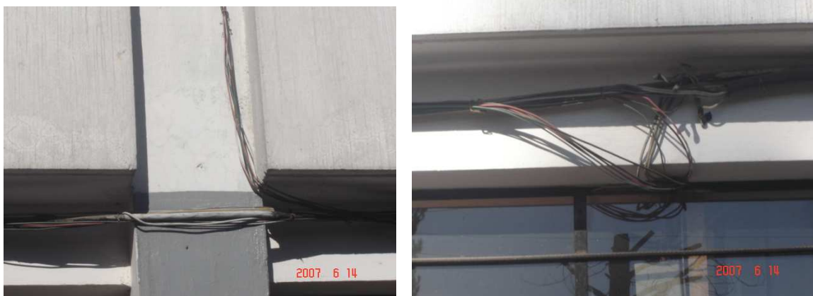
Fig. 1.8: Circuitos de fuerza expuestos a las condiciones climáticas.
