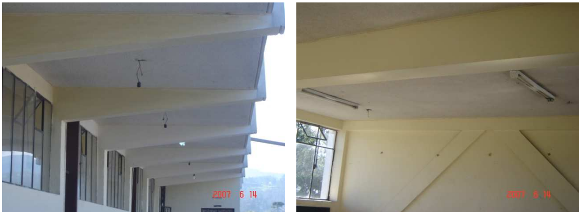
Fig. 1.4: Corredores y aulas con iluminación ineficiente.
