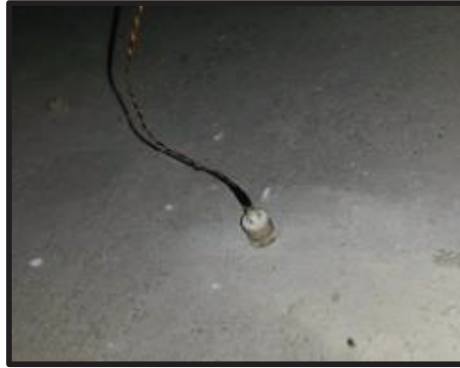
Figura 3.24. Ubicación de la termocupla.
