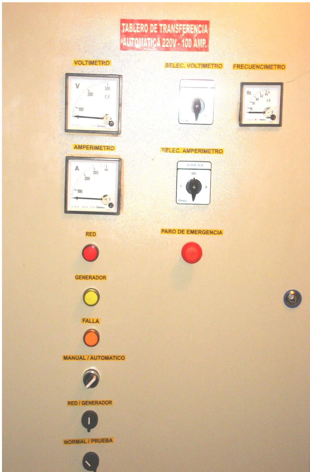
Fig. 3.17. Panel frontal del tablero de transferencia automática
