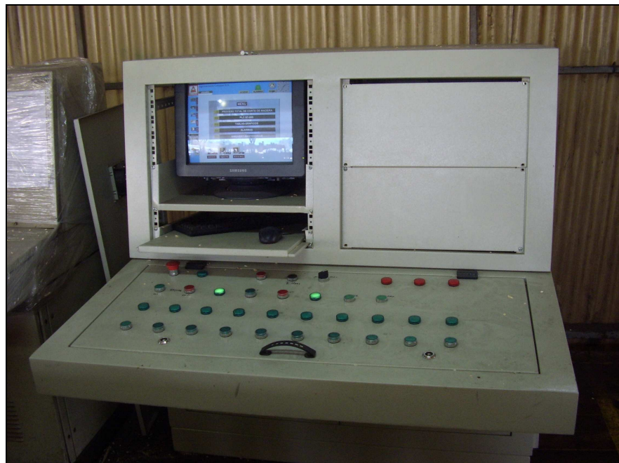
Figura 5.11 Tablero de mando instalado
