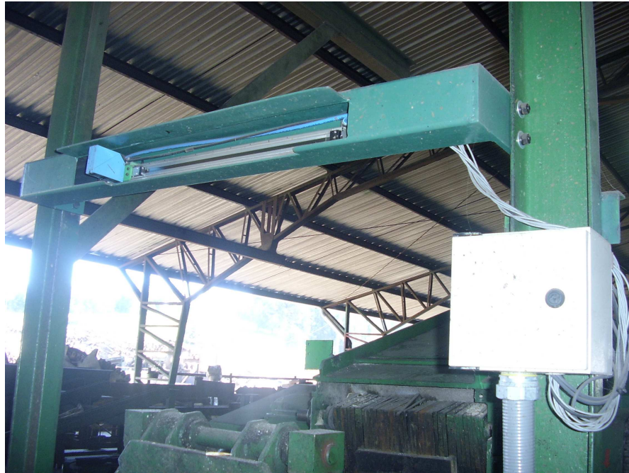
Figura 5.10 Sistema de medición instalado sierra KBO 40
