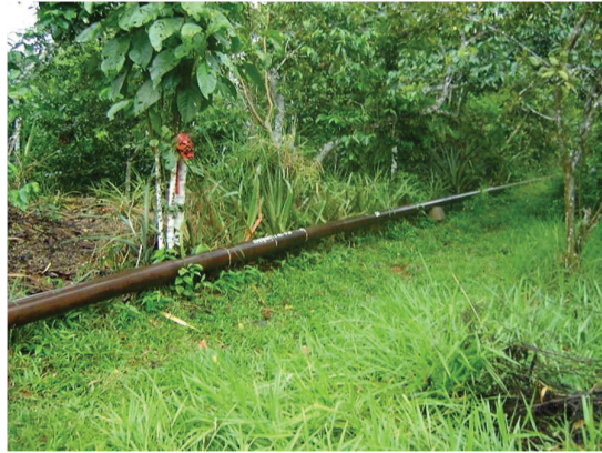
Fotografía 3.11b. Condición de la tubería en sitio
