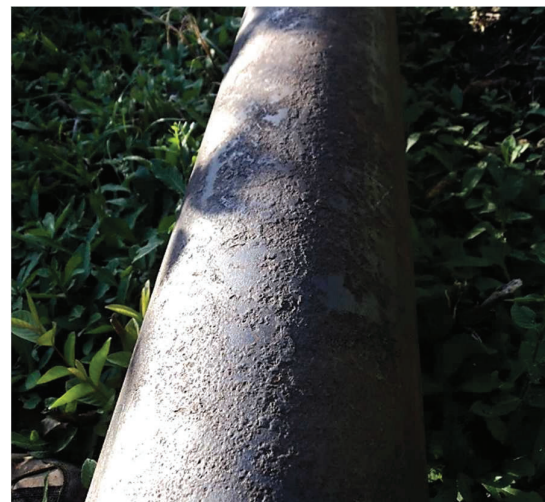
Fotografía 3.6d. Condición de la tubería en sitio
