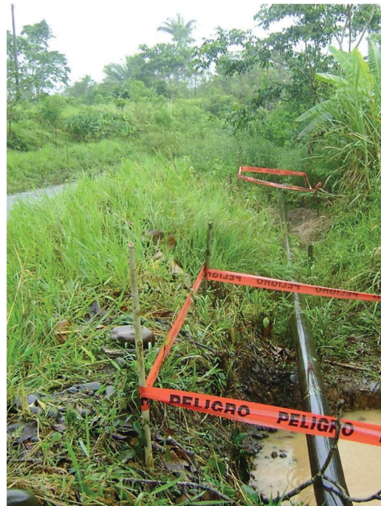
Fotografía 3.15b Condición de la tubería en sitio
