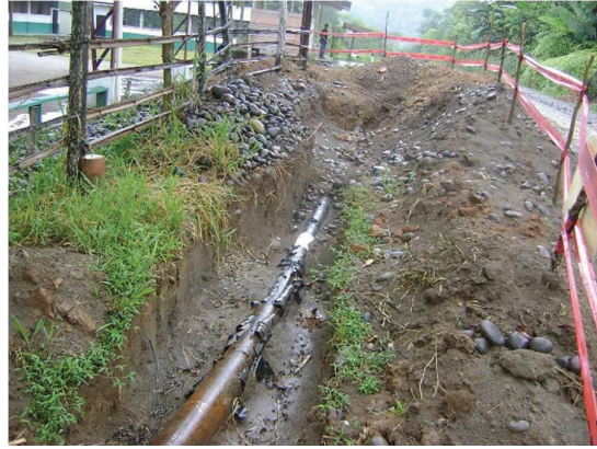
Fotografía 3.7d. Condición de la tubería en sitio
