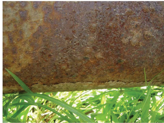
Fotografía 3.3d. Condición de la tubería en sitio
