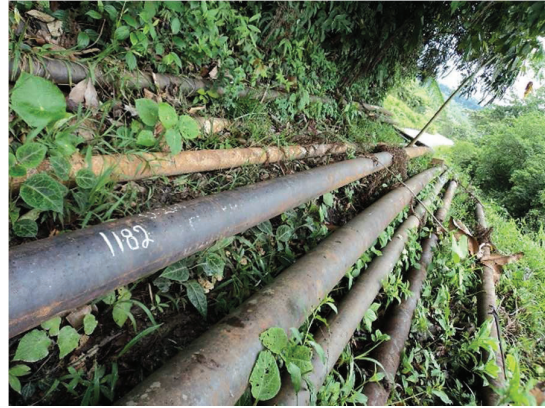
Fotografía 3.16b Condición de la tubería en sitio
