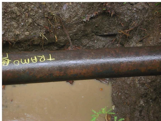
Fotografía 3.13d Condición de la tubería en sitio
