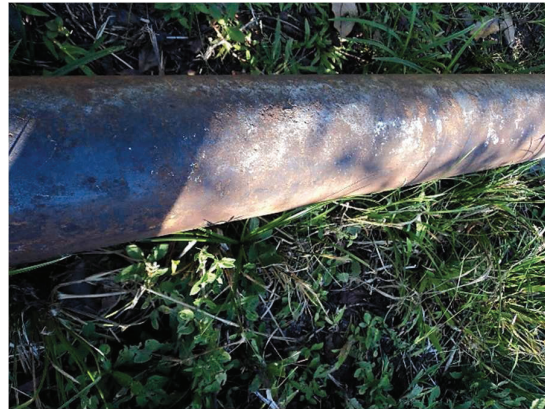
Fotografía 3.6b. Condición de la tubería en sitio
