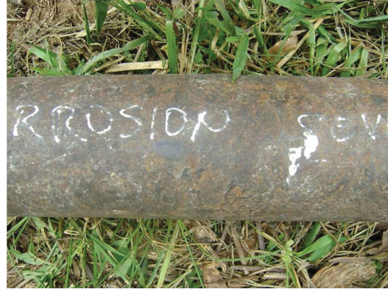
Fotografía 3.2b. Condición de la tubería en sitio
