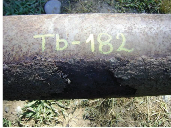
Fotografía 3.1b. Condición de la tubería en sitio
