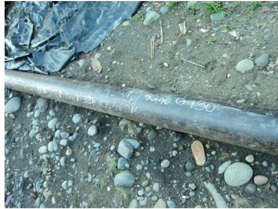
Fotografía 3.4b. Condición de la tubería en sitio
