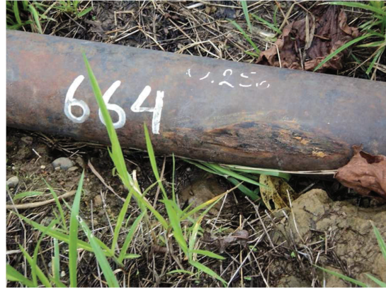
Fotografía 3.14b. Condición de la tubería en sitio
