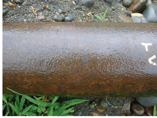
Fotografía 3.7b. Condición de la tubería en sitio
