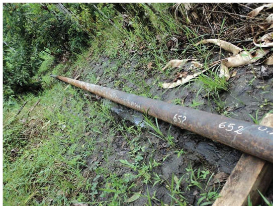
Fotografía 3.13b. Condición de la tubería en sitio
