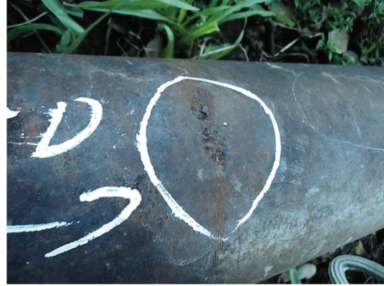
Fotografía 3.9b. Condición de la tubería en sitio
