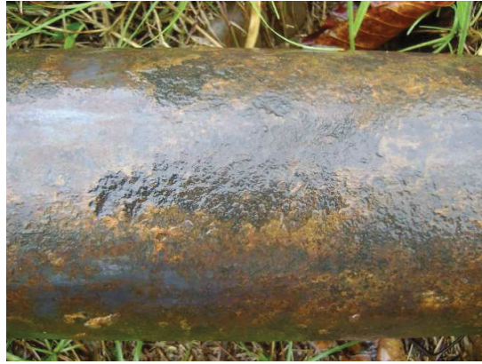
Fotografía 3.10b. Condición de la tubería en sitio
