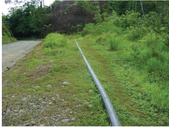
Fotografía 3.12b. Condición de la tubería en sitio
