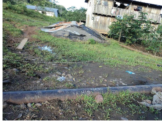
Fotografía 3.8b. Condición de la tubería en sitio
