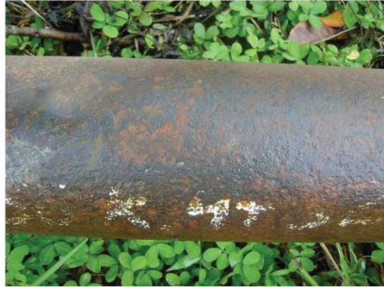
Fotografía 3.5b. Condición de la tubería en sitio
