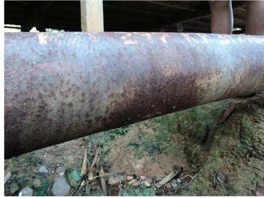
Fotografía 3.3b. Condición de la tubería en sitio
