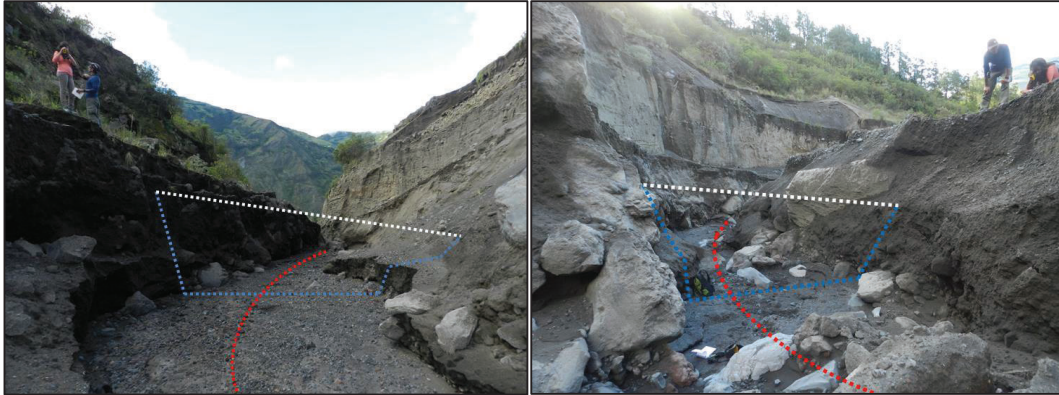
Figura 4.16: Determinación del perfil transversal y la curva transitada (necesarios para la estimación del caudal) en diferentes puntos de la quebrada para un mismo evento.
