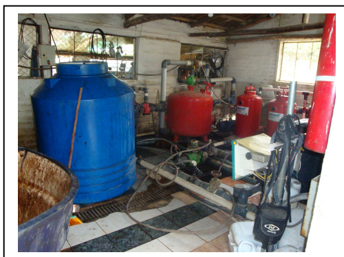
FIGURA No. 3.9 Cuarto caliente
