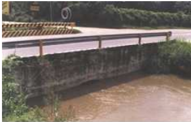
Figura 2. 20 Problemas de agradación en el canal. Insuficiente hidráulica.
