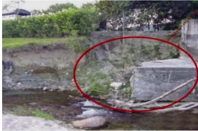
Figura 2. 21 Socavación en terraplén de acceso por cambio en la dirección del flujo.
