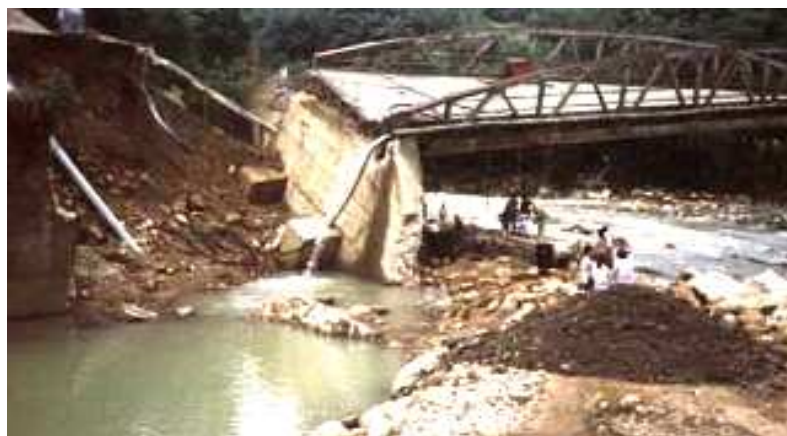
Figura 2. 22 Falla de estribo del Puente Unute (Casanare – Colombia)
