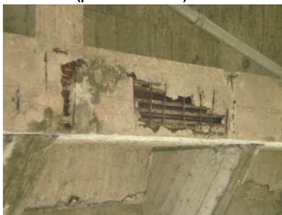
Figura 2.14 Deterioro de la cimentación de un puente sobre un embalse, detectado al final del verano con niveles bajos.
