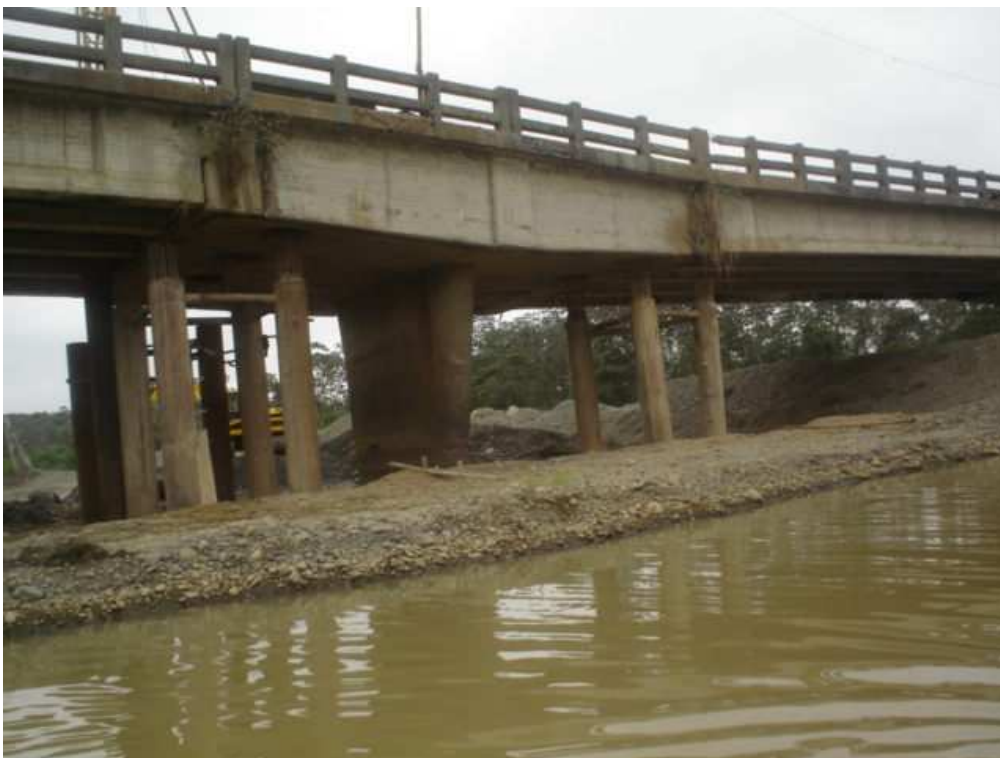
Figura 4. 2 Puente Camarones con la pila afectada, noviembre 2008.
