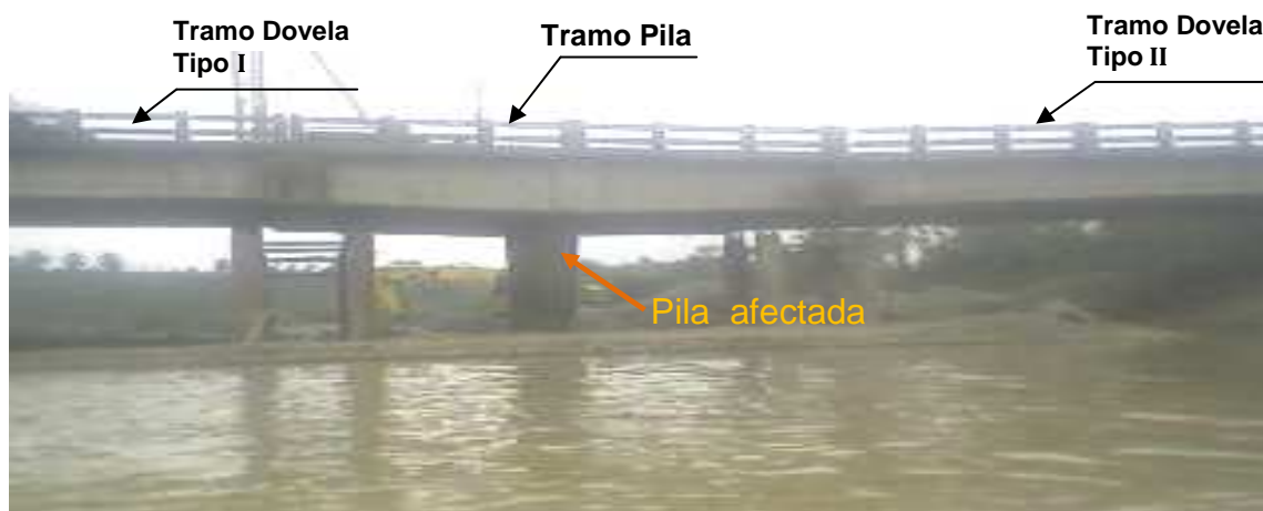
Figura 4. 44 Tres tramos del Puente Tipo de hormigón “Puente Camarones” a ser reparado.
