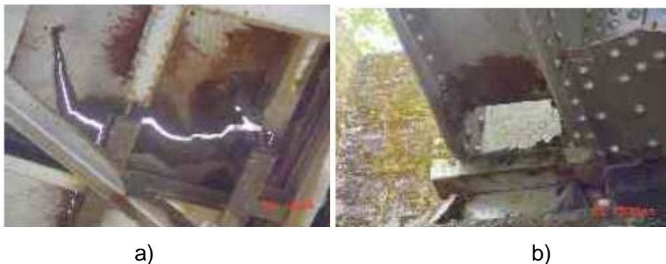
Figura 2. 27 a) Problemas de Corrosión y falla estructura. Puente El Limón (Meta); b) Corrosión Generalizada en el apoyo. Puente El Limón (Meta).
