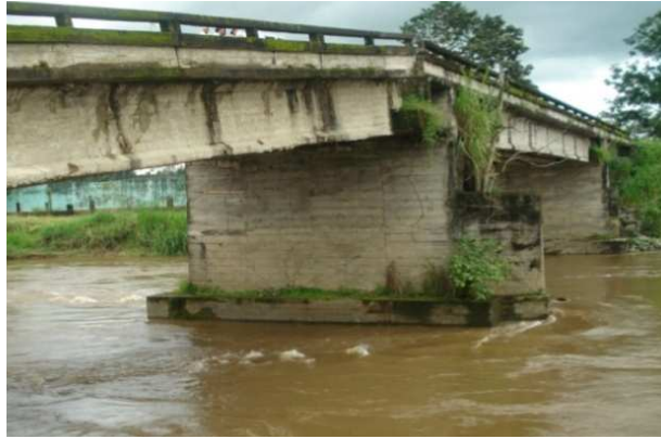
Figura 2. 24 Puente Tipo colapsado por socavación en pilas.
