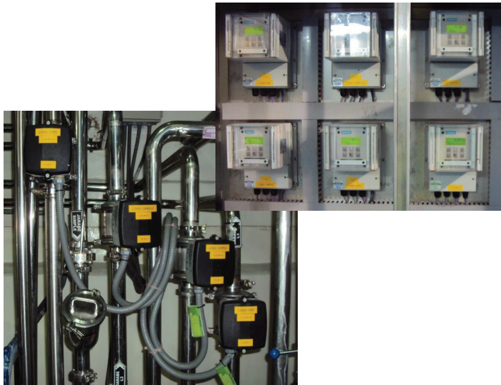
Figura 6.17 Sensores y transmisores de caudal instalados
