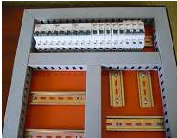
FIGURA 3.27 Ubicación de las protecciones en el tablero
