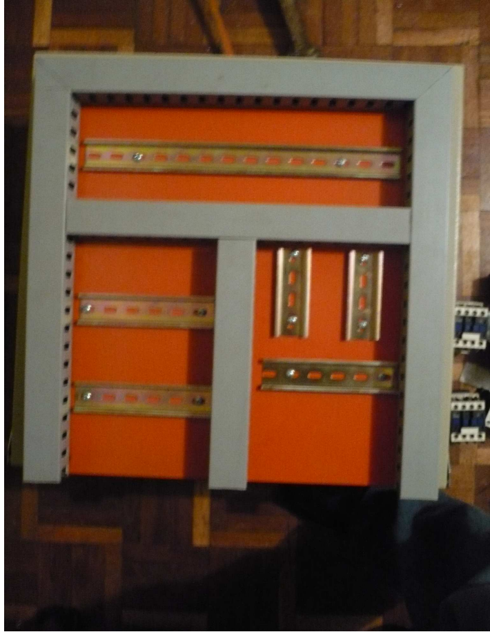
FIGURA 3.30 Doble fondo con canaletas y rieles.
