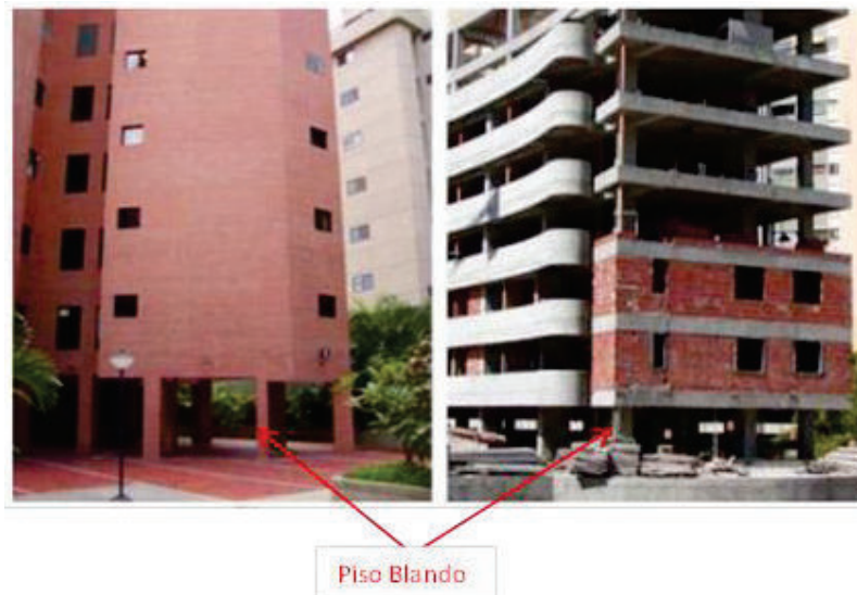
FIGURA 3.3 EFECTO DE PISO BLANDO
