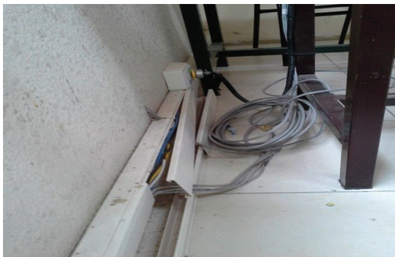
Figura 2.18 Canaletas para el enrutamiento
