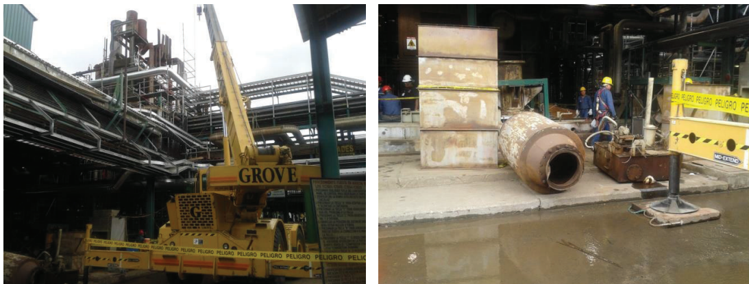
Figura 3.6 Medidas ingenieriles en las calderas y turbo generadores de la Planta de Utilidades de la Refinería de Esmeraldas
