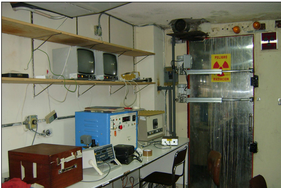
Figura e.10: Sala de control
