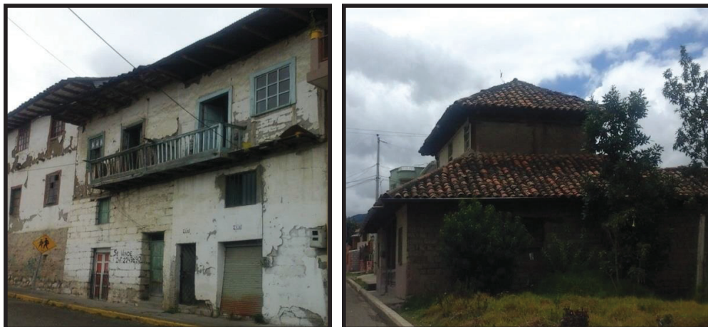
FIGURA 5.4 EDIFICACIÓN DE MAMPOSTERÍA DE ADOBE EN MAL ESTADO PERO HABITADA.
