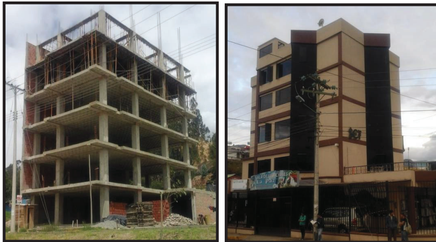
FIGURA 5.13 TIPOLOGÍA CONSTRUCTIVA DE HORMIGÓN ARMADO SIN DISEÑO SISMORESISTENTE, EDIFICIO DE MÁS DE 5 PISOS
