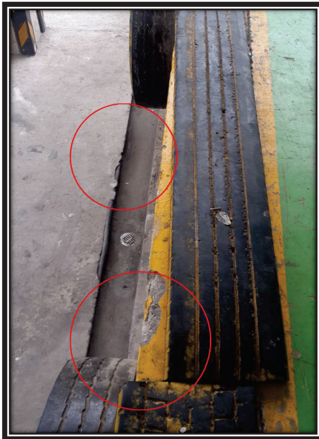
Figura 9 - Piso del andén de carga
