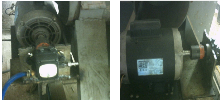
Fotografía 19. Bomba del combustible.
