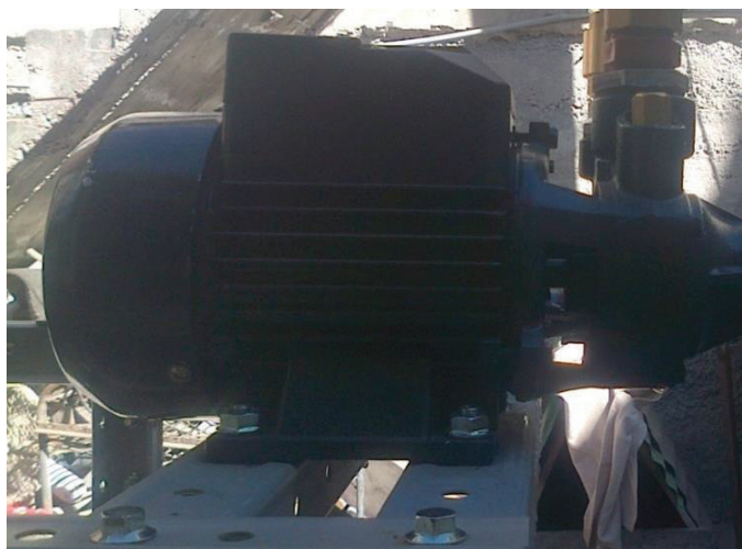
Fig.27. Bombas aseguradas a estructura
