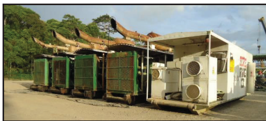
Figura 2.3 Generador, motores de combustión interna y transformador
