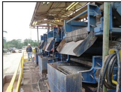
Figura 2.15 Zarandas del fluido de perforación
