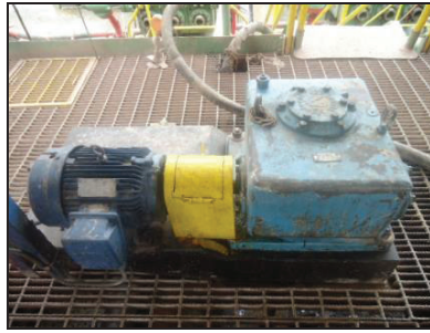
Figura 2.14 Motores electromecánicos de los tanques del lodo
