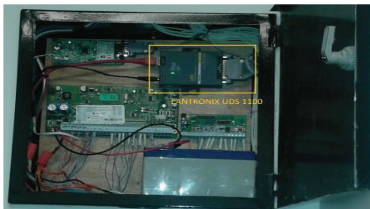
Figura 2.38 Central de alarmas PC1864-Lantronix UDS 1100.
