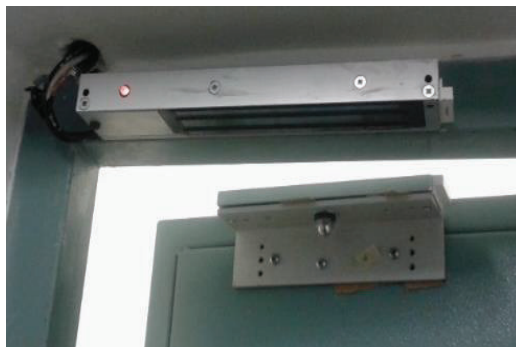
Figura 2.113 Cerradura (Cuartos Eléctricos).
