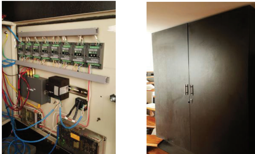
(b) Implementación de módulos adicionales y armario de tableros.
