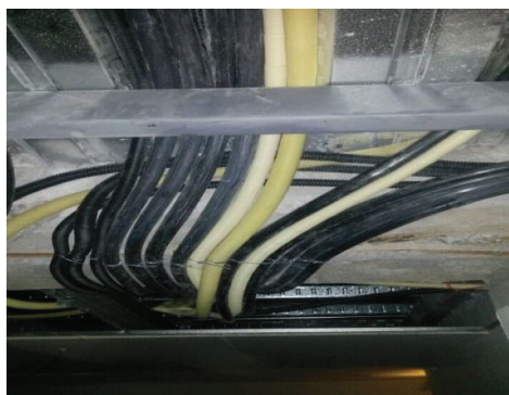
(b) Ductería utilizada hacia el tablero principal
