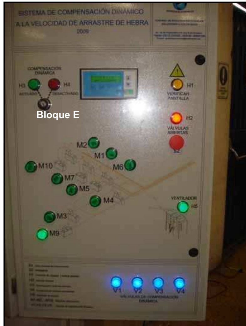
Fig. 2.22 Puerta de tablero de control
