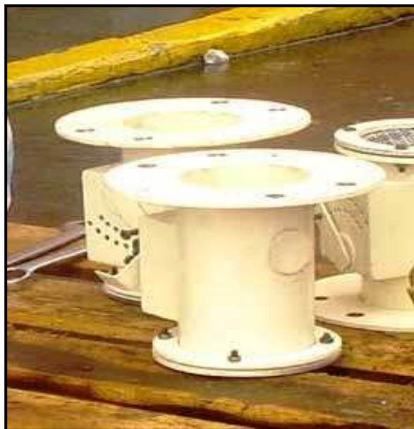
Fig. 2.15 Brida acoplada a válvula de accionamiento manual
