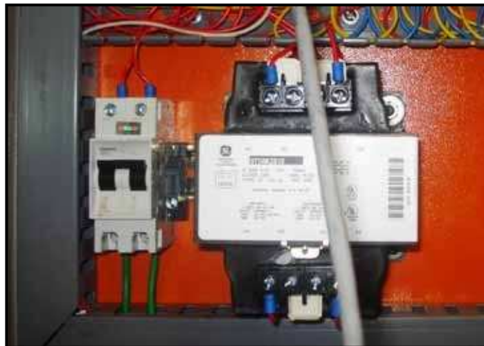
Fig. 2.29 Transformador General Electric.
