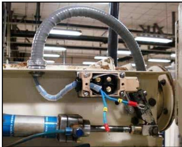
Fig.2.7. Conexionado del sensor
