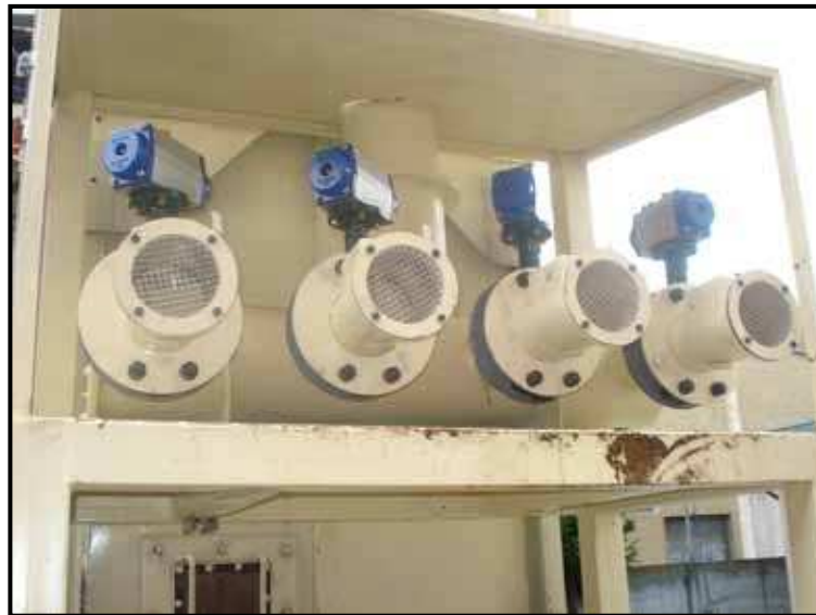
Fig. 2.16 Válvulas de compensación montadas
