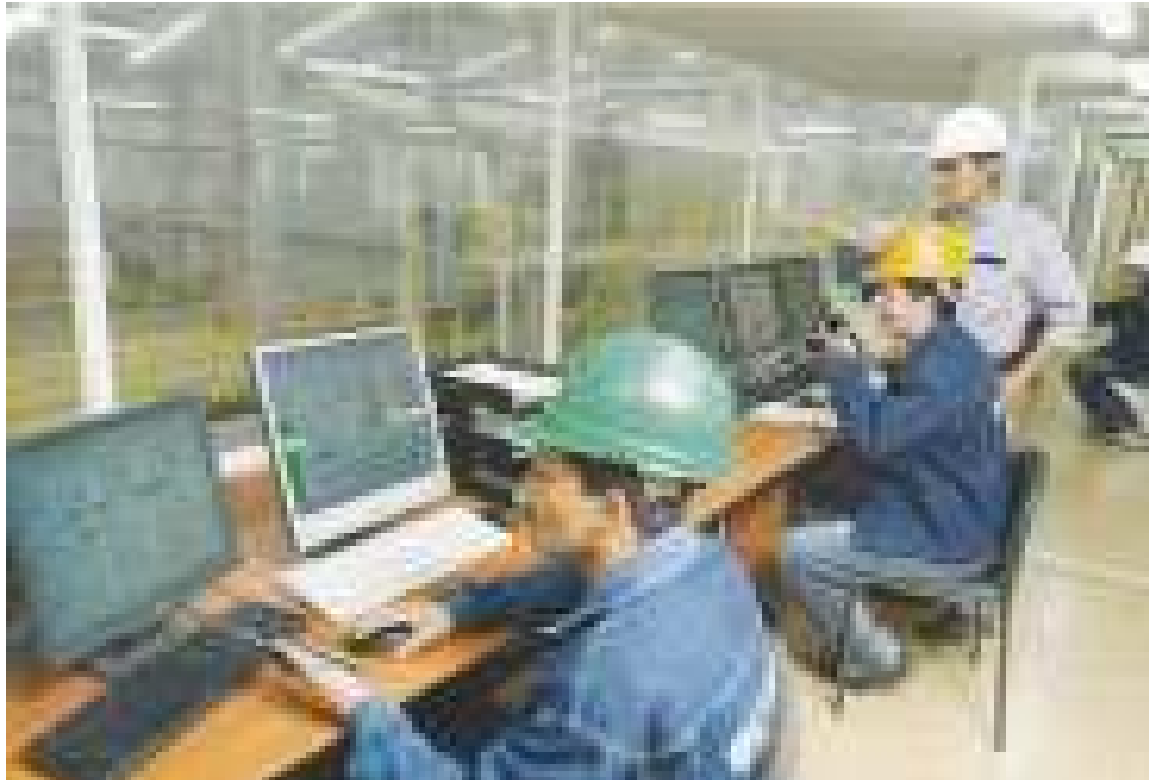
Figura 3.10. Cuarto de control
