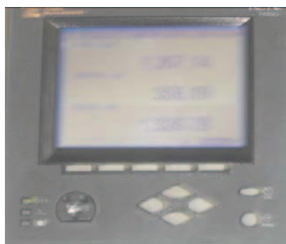
FIG. 1.55 Medidor ION Enterprise 7650 ubicado en la Central San Francisco.
