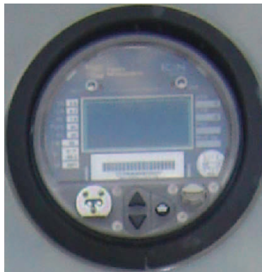
FIG 1.52 Medidor ION Enterprise 8600 ubicado en la S/E San Agustín.
