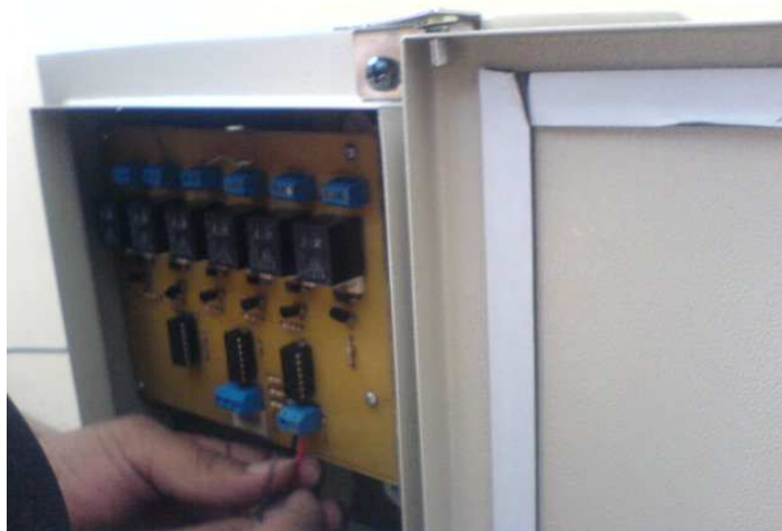
Gráfico 3.15 MONTAJE DE LA TARJETA DE AMPLIACIÓN DE SALIDAS
