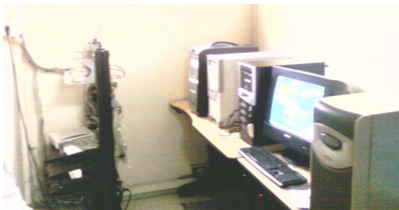
Figura 2.1: Cuarto de equipos en TELCOLSAM S.A.
