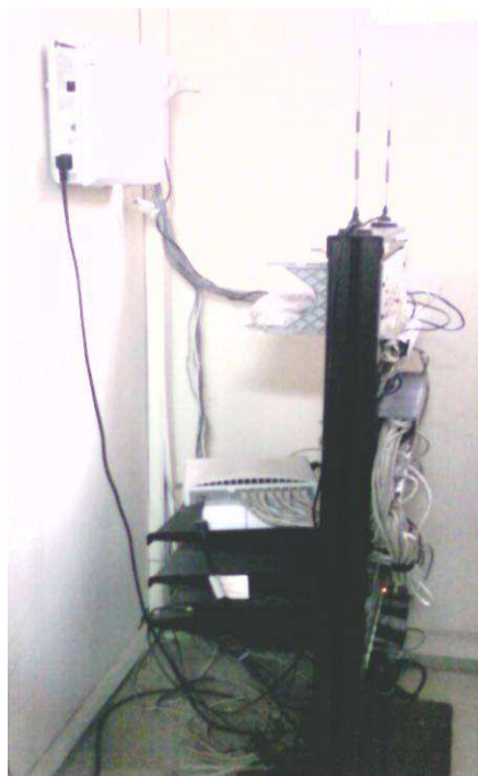
Figura 2.2: Rack de equipos de interconectividad.
