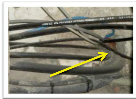
Figura 2.15 Ingreso de servicios al cuarto de Equipos
