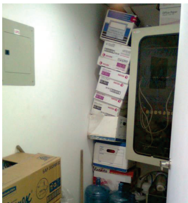
Figura 2.32. Estado del cuarto de comunicaciones Noveno Piso
