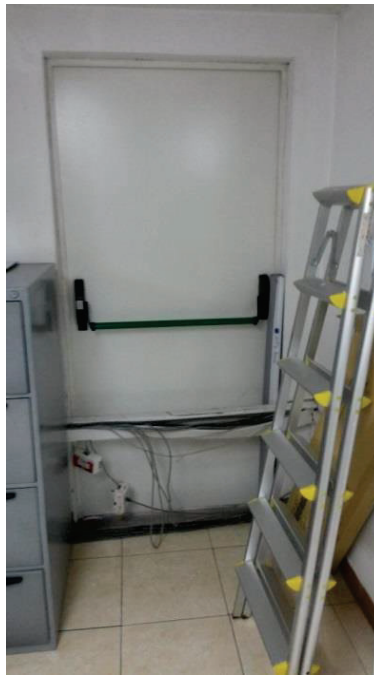
Figura 2.16. Estado actual cableado estructurado Segundo Piso
