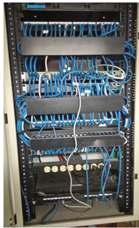
Figura 2.34. Estado del gabinete de comunicaciones Décimo Piso
