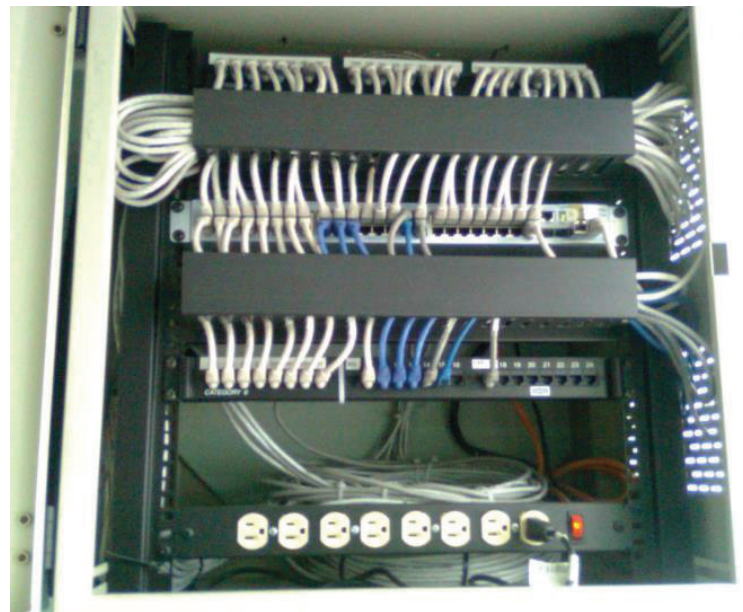
Figura 2.27. Estado del cableado en el gabinete de comunicaciones Séptimo Piso
