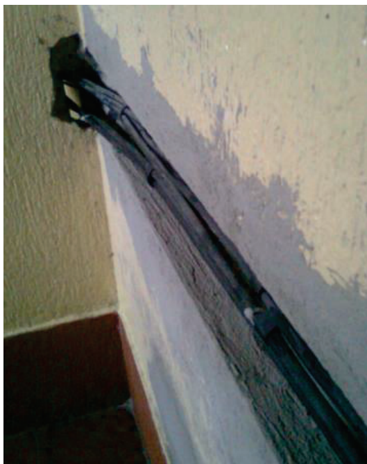
Figura 2.20. Estado actual del cableado estructurado del Cuarto Piso
