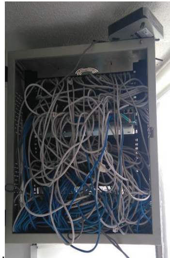
Figura 2.24. Estado del cableado en el gabinete de comunicaciones Sexto Piso
