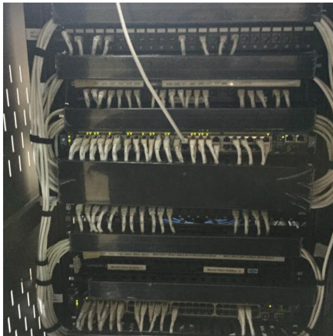
Figura 2.21. Rack de comunicaciones Quinto Piso
