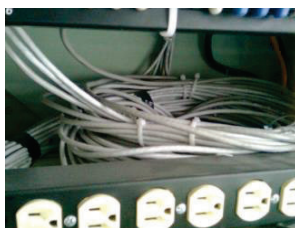
Figura 2.29. Estado actual del cableado estructurado en el gabinete de comunicaciones Séptimo Piso
