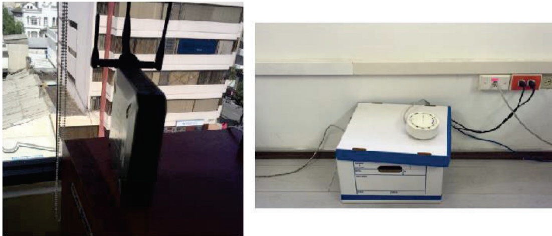
Figura 2.22. Access point Quinto Piso
