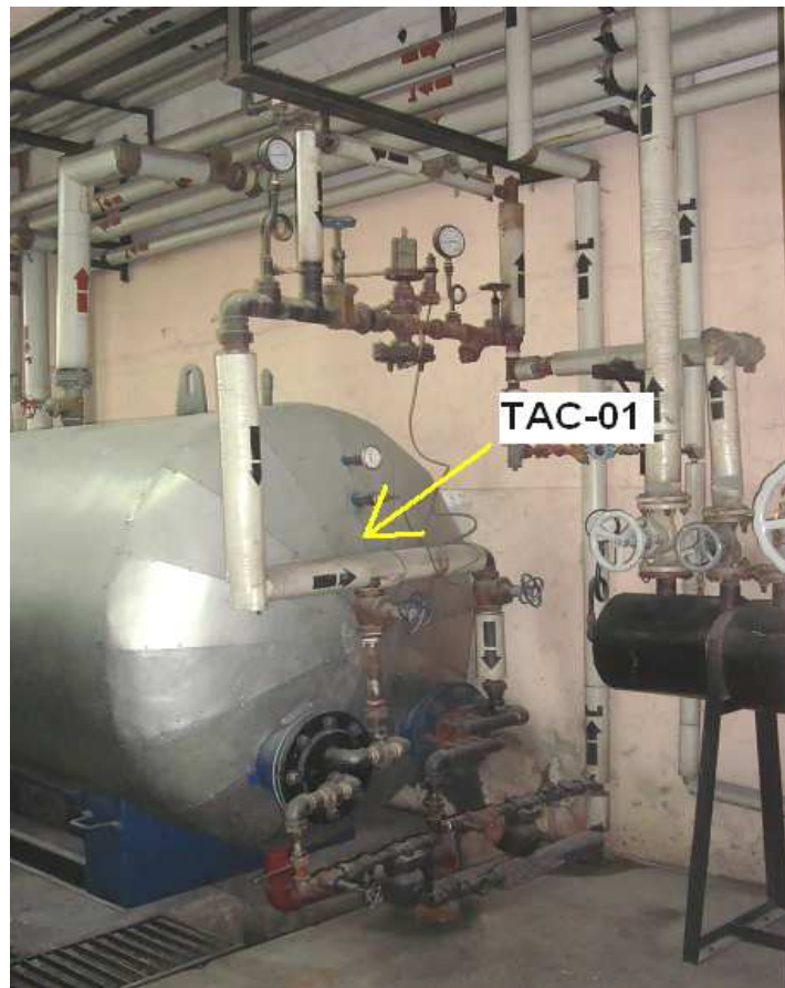
Figura 3.9 Tanque de almacenamiento de agua caliente
