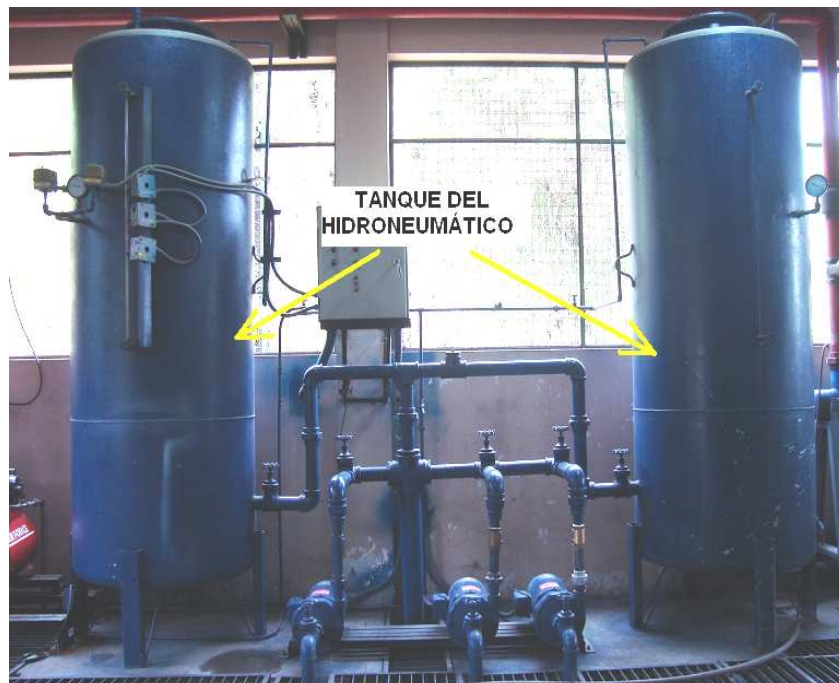
Figura 3.4 Tanque del sistema hidroneumático
