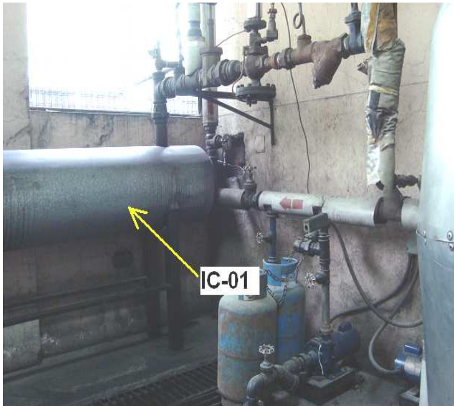
Figura 3.10 Intercambiador de calor
