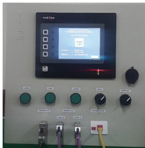
Figura 3.16. Parte frontal tablero de Control
