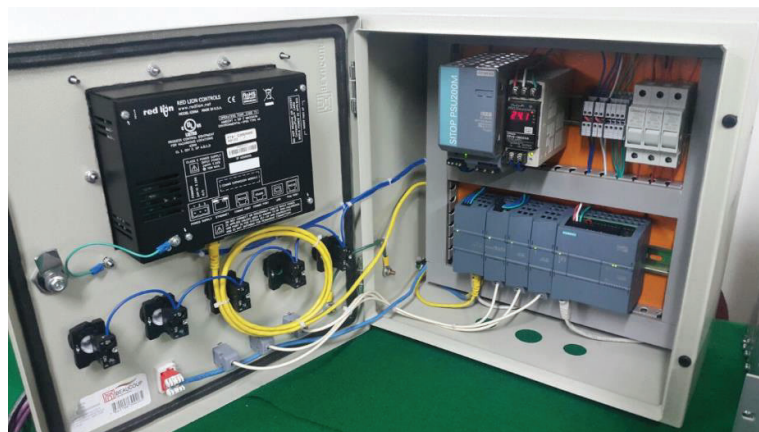
Figura 3.17. Parte interior del tablero de Control
