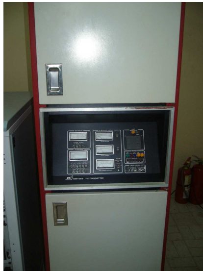
Figura 2.9 Amplificador de Potencia de RF 695T5KW de QEI que funciona en la cabina de transmisión
