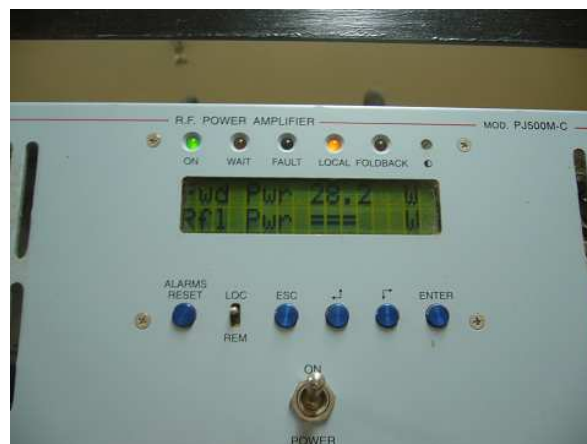
Figura 2.8 Amplificador de Potencia de RF PJ500M-C/LCD de R.V.R. que funciona en la cabina de transmisión
