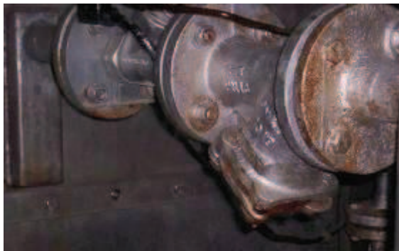
Figura N°3. 50 Fuga de vapor en filtro de vapor de HNHO2000. D. aprox. 3/16”.
