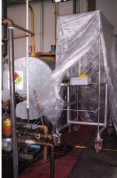
Figura N° F. 9 Medición del flujo de bunker de la bomba del tanque diario.
