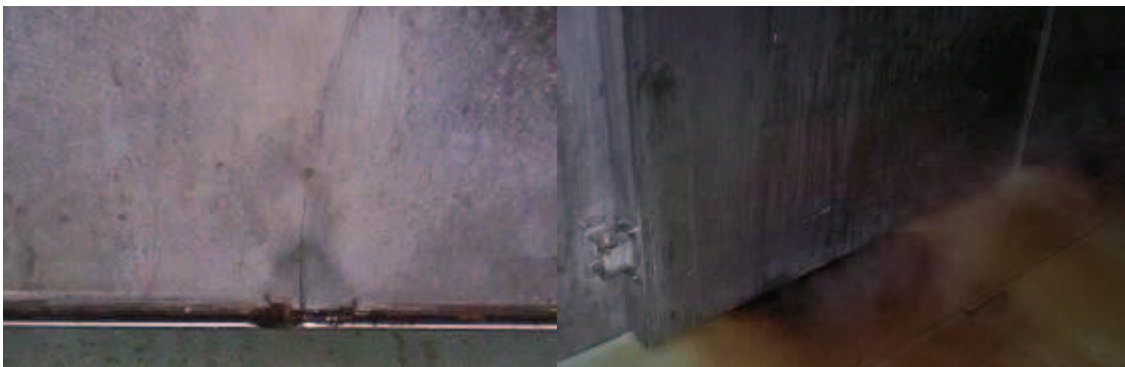
Figura N°3. 47 Fuga de vapor en empaque de la puerta de HNHO3000.
