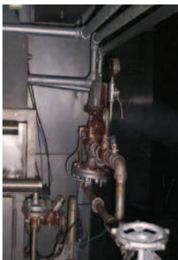
Figura N°3. 51 Fuga de vapor en válvula reguladora de acción de presión controlada externamente de HNHO2000. D. aprox. 7/32”.
