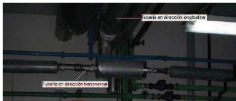
Figura N°3. 24 Ramificación de la tubería principal del distribuidor de vapor.
