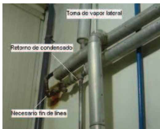
Figura N°3. 25 Suministro de vapor de la última marmita, HNMA 1000.
