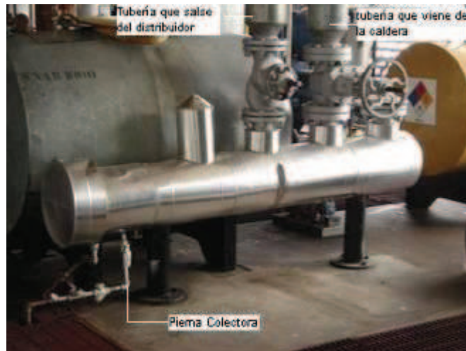
Figura N°3. 22 Distribuidor de vapor.
