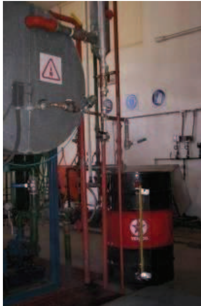
Figura N° F. 5 Desviaciones y recipiente empleado para medir el retorno de condensado.
