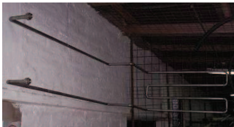
Figura N°3. 8 Serpentín de calentamiento de bunker.
