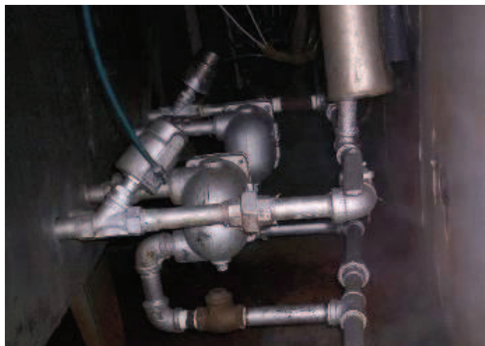
Figura N°3. 44 Fuga de vapor en unión una universal y en un neplo.
