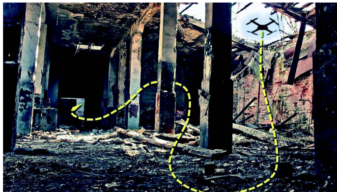
Figura 1. 4. Drones autónomos que vuelan por edificios inestables o espacios peligrosos a 20m/s, evitando la necesidad de presencia física [8].
