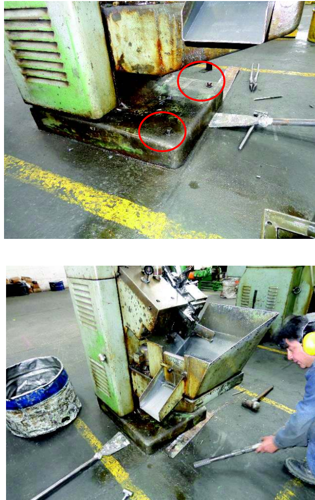
Figura 3.27. Desmontaje de pernos dañados y sin ajuste de la roscadora R7
