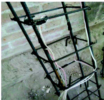
Fotografía 3.21 – Direccionamiento de Cables.
