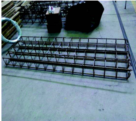
Fotografía 3.8 – Vigas Prefabricadas de 20 x20.
