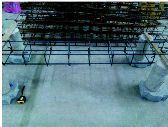
Fotografía 3.11 – Vigas armada con Estribos.
