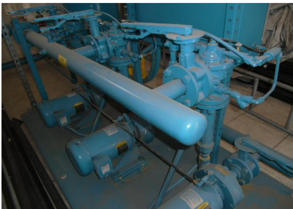
Figura 2.12. Sistema de bombeo de agua potable (sistema de presión constante)
