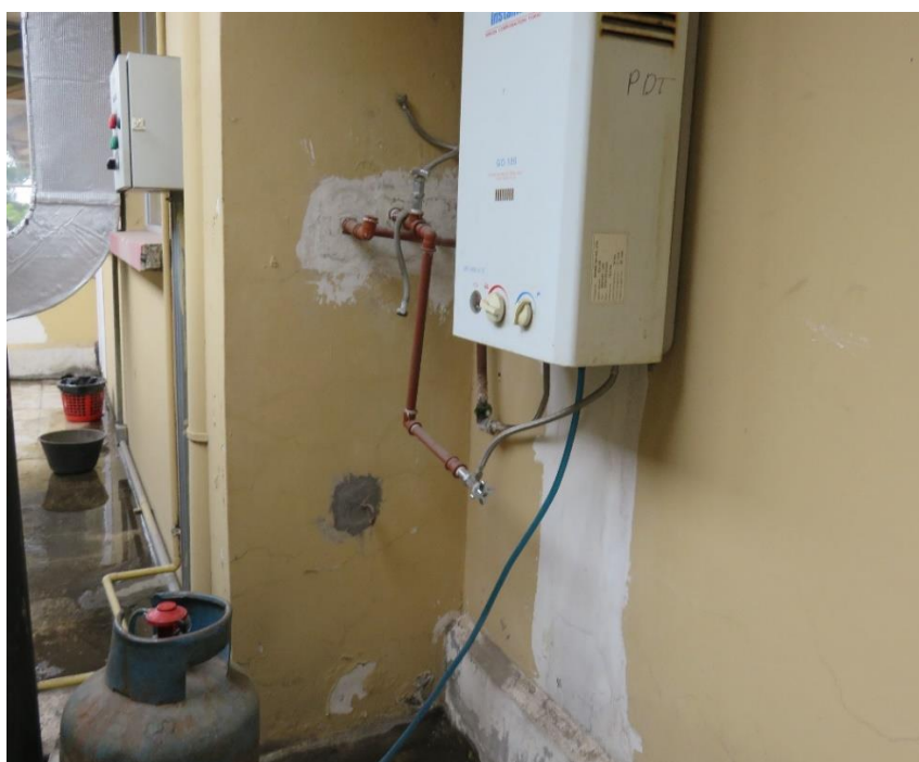
Figura 2.11. Calentamiento de agua con calefones
