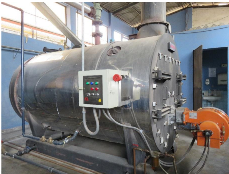
Figura 2.14. Caldero nuevo de 100 BHP
