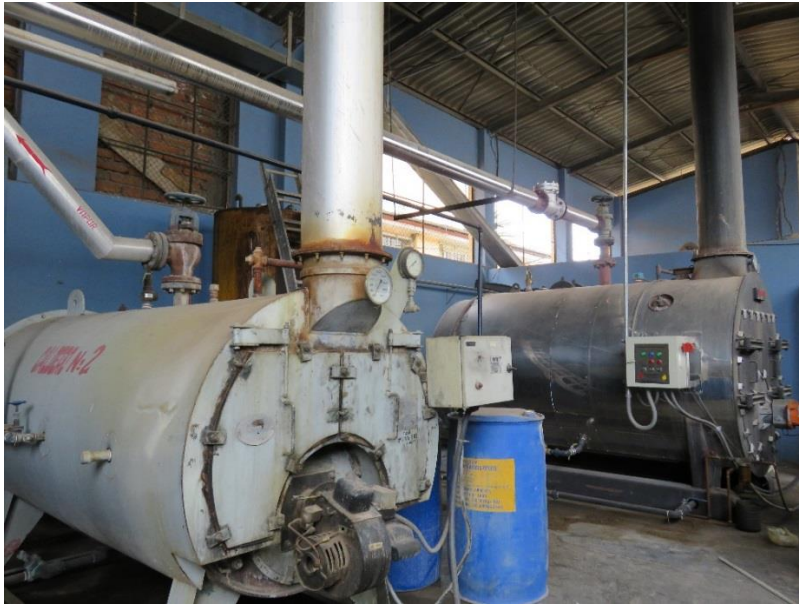
Figura 2.13. Calderos antiguos actualmente sin funcionar
