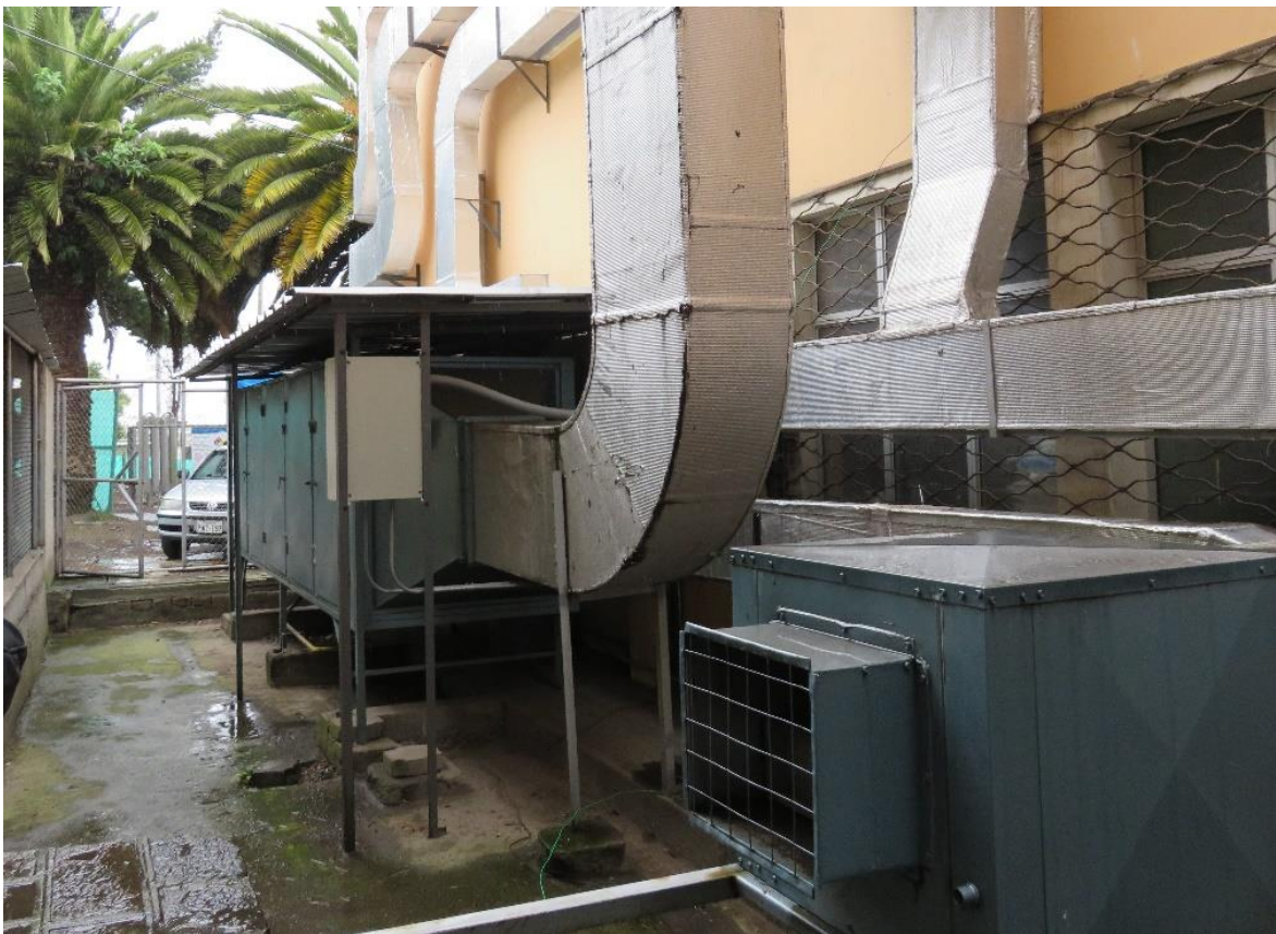
Figura 2.6. Equipos de climatización instalados en patio exterior
