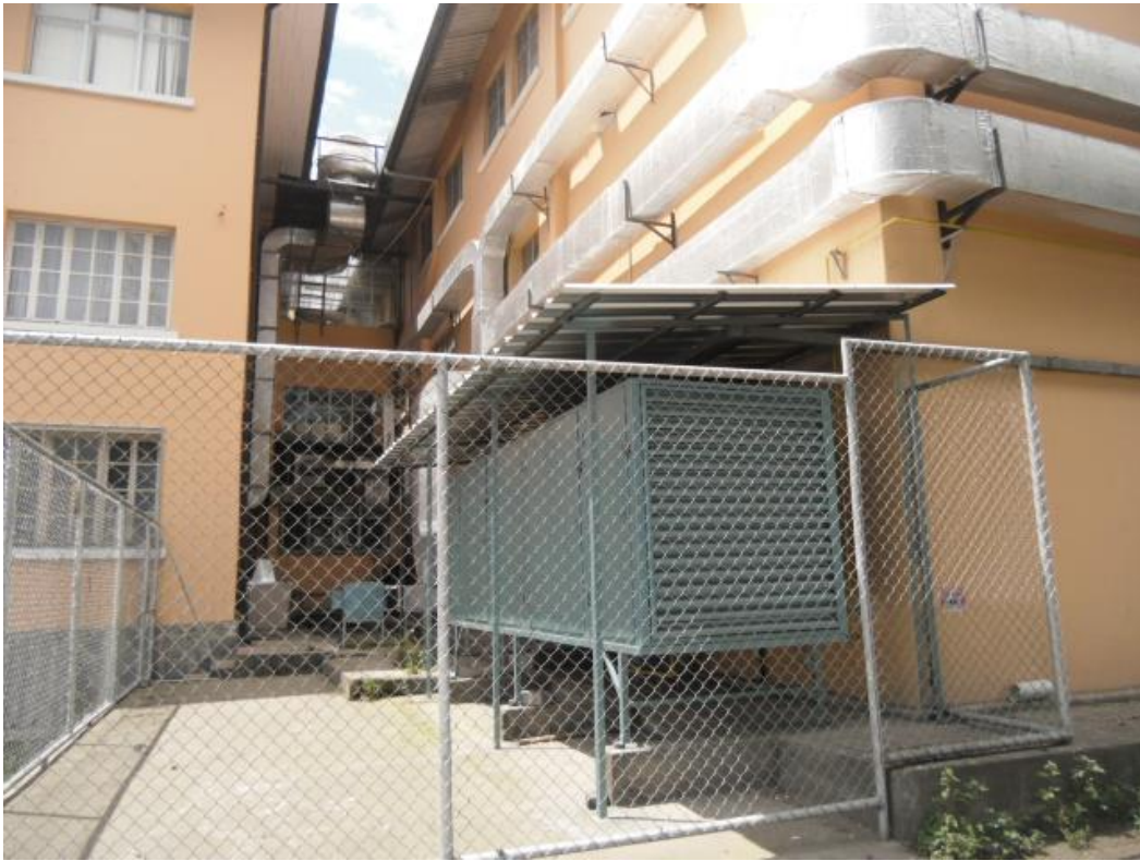
Figura 2.8. Sistema de climatización del Centro Quirúrgico
