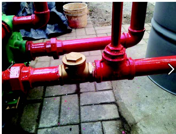
Figura 77. Válvula check sin pintura.
