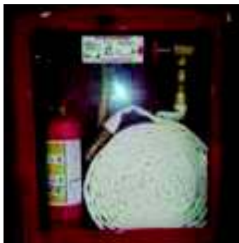
Figura 1. Boca de incendios equipada
