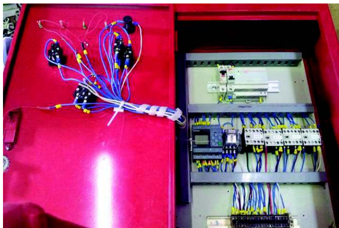
Figura 79. Gabinete metálico abierto.
