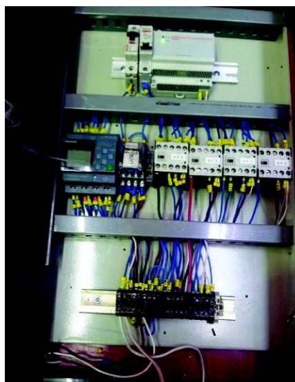
Figura 80. Cableado componentes gabinete metálico.
