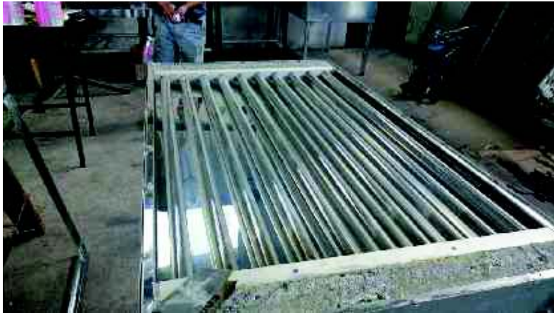
Figura 4.7. Ensamblaje del colector.
